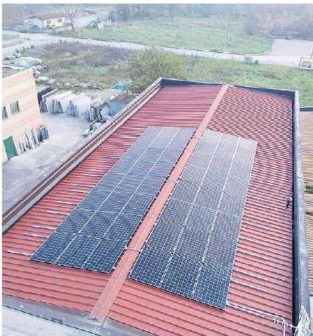
L'impianto fotovoltaico sul tetto della caserma di Varzi
